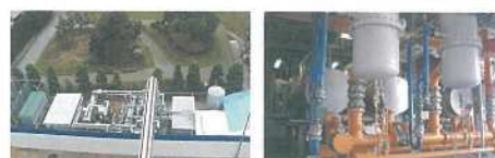
高効率CO 2 /NH 3 カスケード二元冷凍システム
